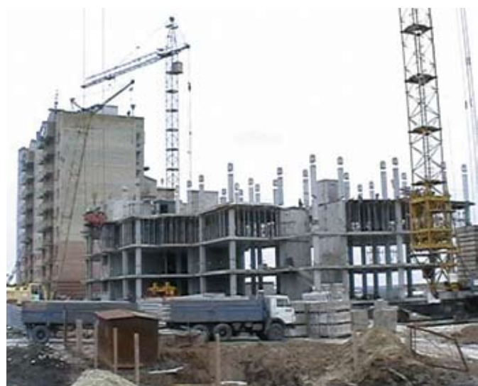
Фото 3. Монтаж сборно-монолитного каркаса в г. Ст. Осколе Белгородской обл. ведет ООО «Индустрия строительства».
